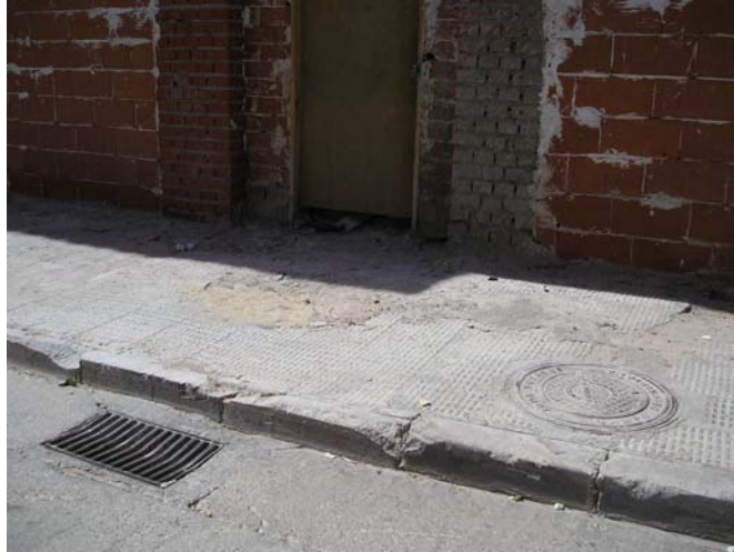
Imagen 7. Pavimentado de acera deteriorado.
