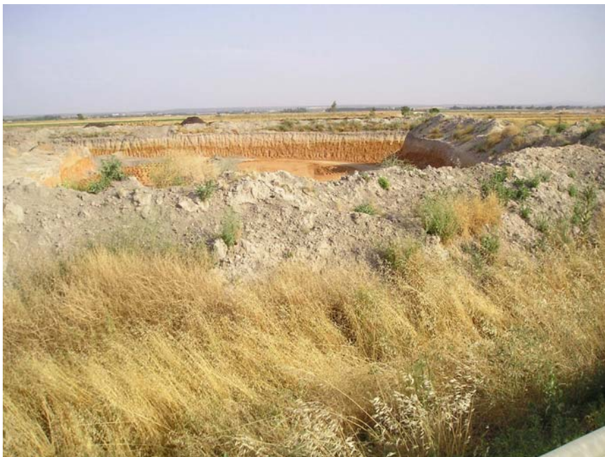
Imagen 1. Vaciado de terrenos con elevado impacto ambiental (paisajístico). Taludes verticales.
